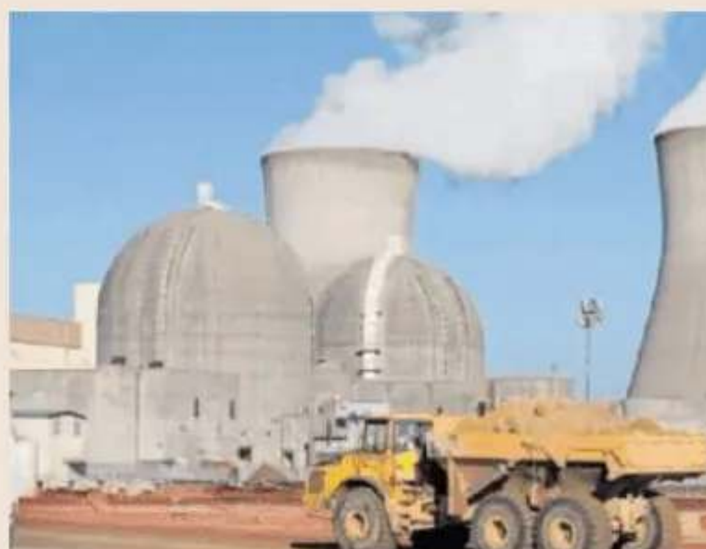
Planta nuclear con reactor diseñada por Westinghouse, en Georgia (EE UU). EFE
